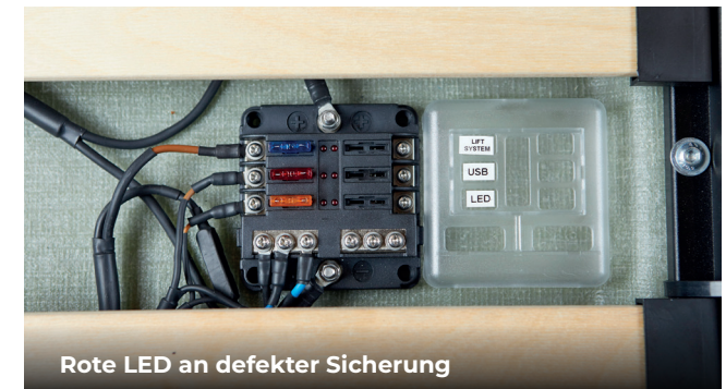
Sicherungskasten mit Beschriftung Sicherung 1-4
