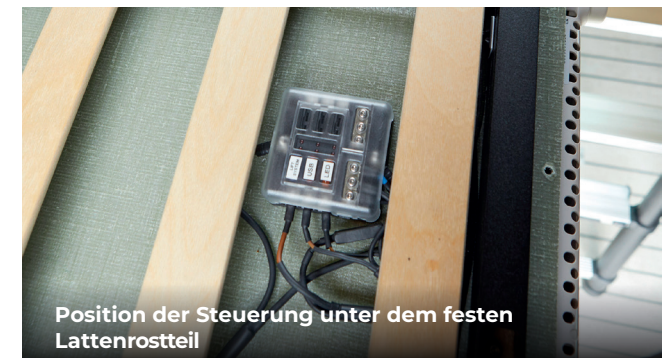
Rote LED an defekter Sicherung
